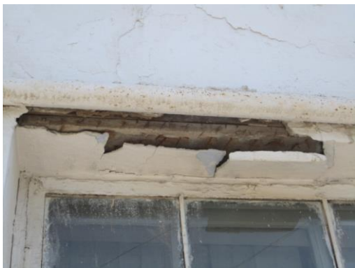
В перемычках оконных проемов сквозные трещины
