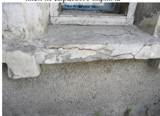
Трещины в кирпичной кладке оконного проема
