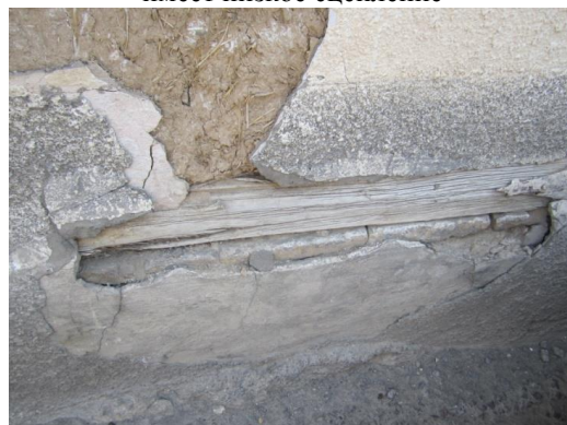
Фрагмент разрушения цокольной части здания основного блока
